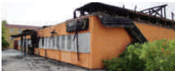
Enskilt största skadan under 2010 var skolbranden i Rinkeby Akademin. S:t Erik Försäkring försäkrar hela byggnaden och inventarierna. Beräknad kostnad är cirka 11 miljoner kronor.
