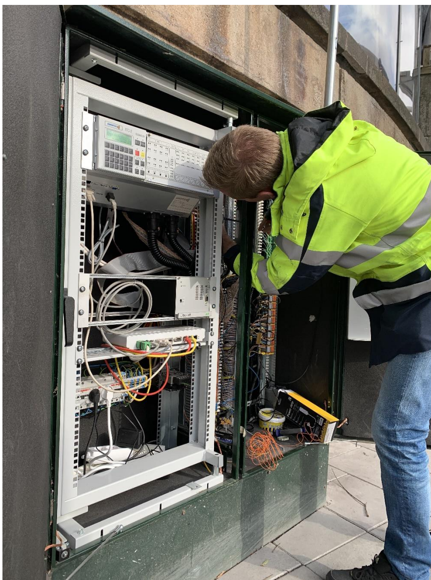
Bild 4 Installationen är relativt enkel och i apparatskåpet finns även elförsörjning för tillkommande DynKap-utrustning
